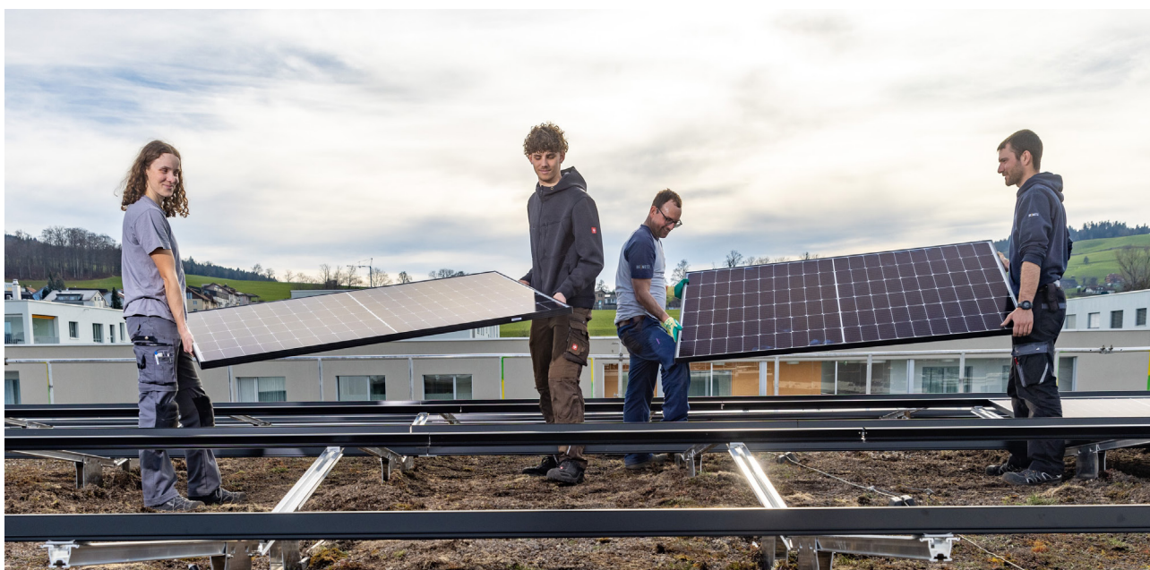
Fotoshooting « Neue Berufslehren Solarinstallateur:in und Solarmonteure:in ab 2024/2025 », mehr Infos: solarlehre.ch, © Swissolar / Reto Schlatter Séance photo « Nouveaux apprentissages professionnels Installatrice et installateur solaire, monteuse et monteur solaire à partir de 2024/2025 », plus d'informations: formation-solaire.ch, © Swissolar / Reto Schlatter
